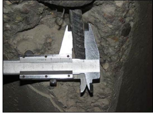
ФОТО 26. Уточнение диаметра рабочей арматуры монолитного ж/б пилона 3-го этажа на пересечении осей «Б/4» и «3/4».
