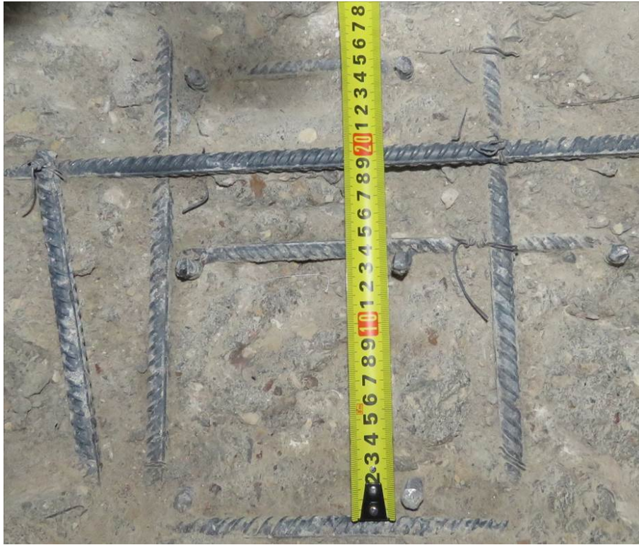
Рис. 3.1.7. Замер шага вдоль буквенных осей поперечного армирования фундаментной плиты на участке вскрытия по оси б/4 между осями Б/4-В/4 секции 4
