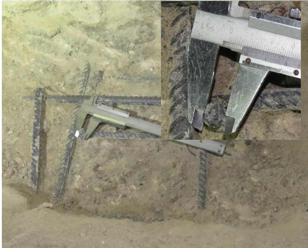
Рис. 3.1.10. Определение диаметра (10 мм) арматуры поперечного армирования фундаментной плиты на участке вскрытия по оси 6/4 между осями Б/4-В/4 секции 4
