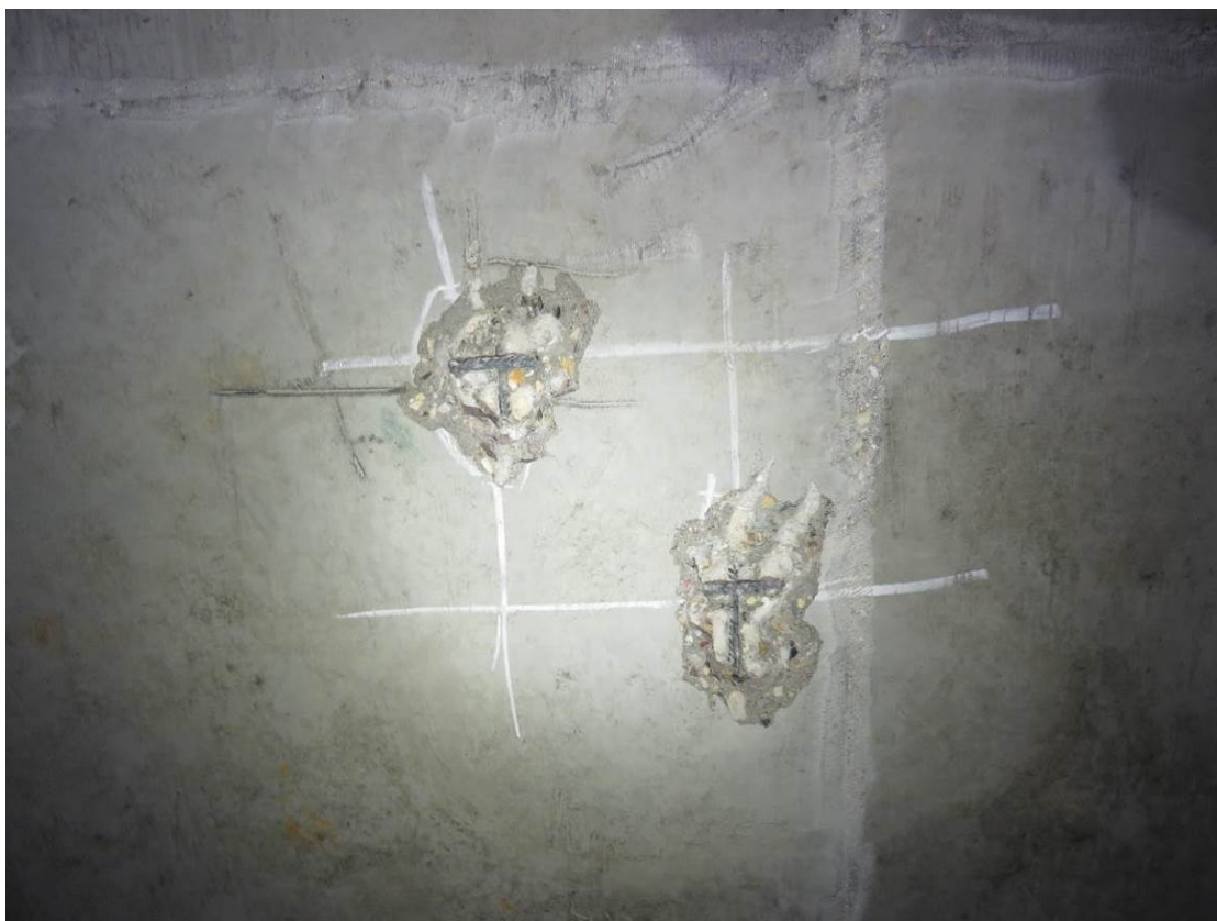
Рис. 3.3.5. Общий вид участка вскрытия монолитной ж.б. плиты перекрытия подвала по оси И/4 между осями 2/4-3/4 (зона нижнего армирования)
