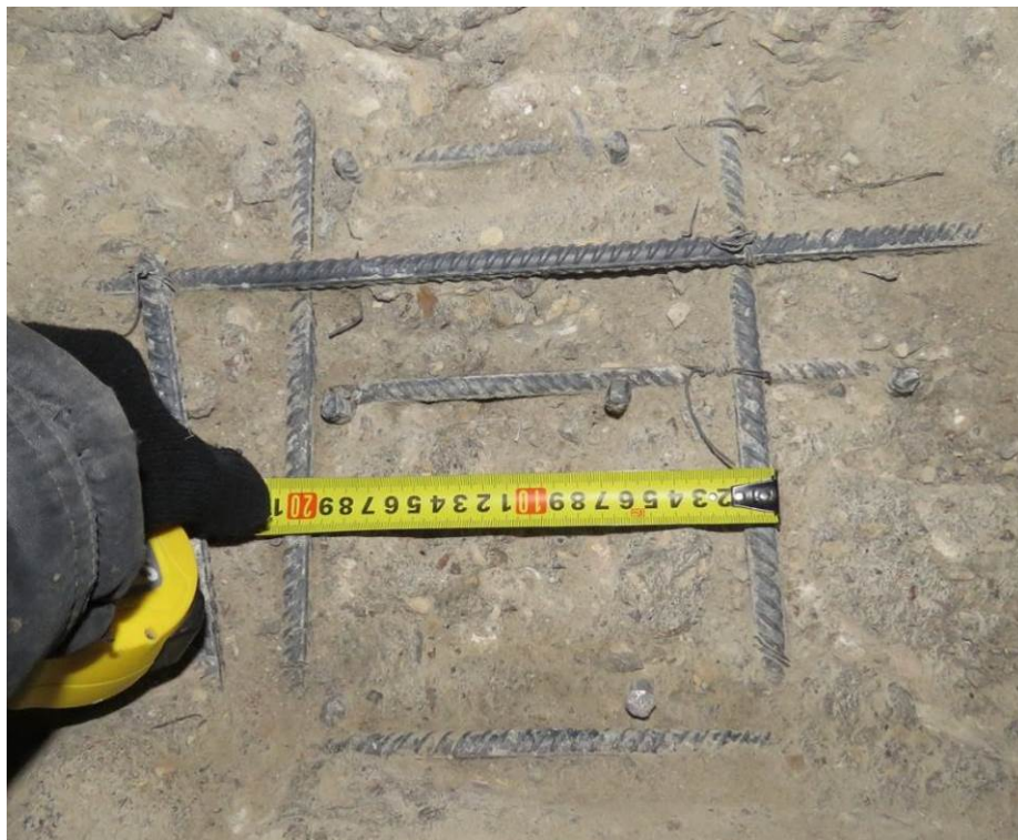
Рис. 3.1.4. Замер шага вдоль цифровых осей верхней зоны армирования фундаментной плиты на участке вскрытия по оси 6/4 между осями Б/4-В/4 секция 4
