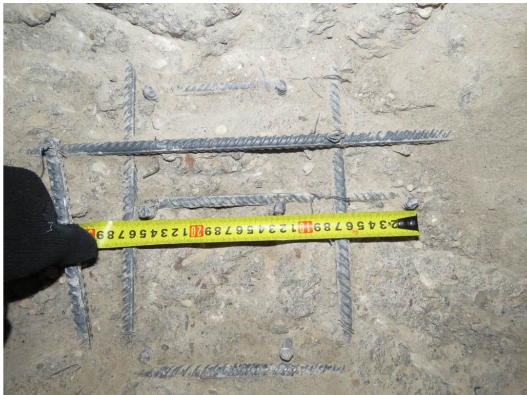
Рис. 3.1.6. Замер шага вдоль цифровых осей поперечного армирования фундаментной плиты на участке вскрытия по оси б/4 между осями Б/4-В/4 секция 4
