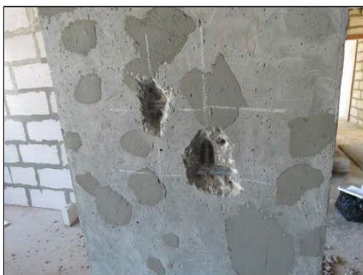
ФОТО 15. Общий вид вскрытия монолитного ж/б пилона расположенного на пересечении осей «Ж/3» и «8/3».
