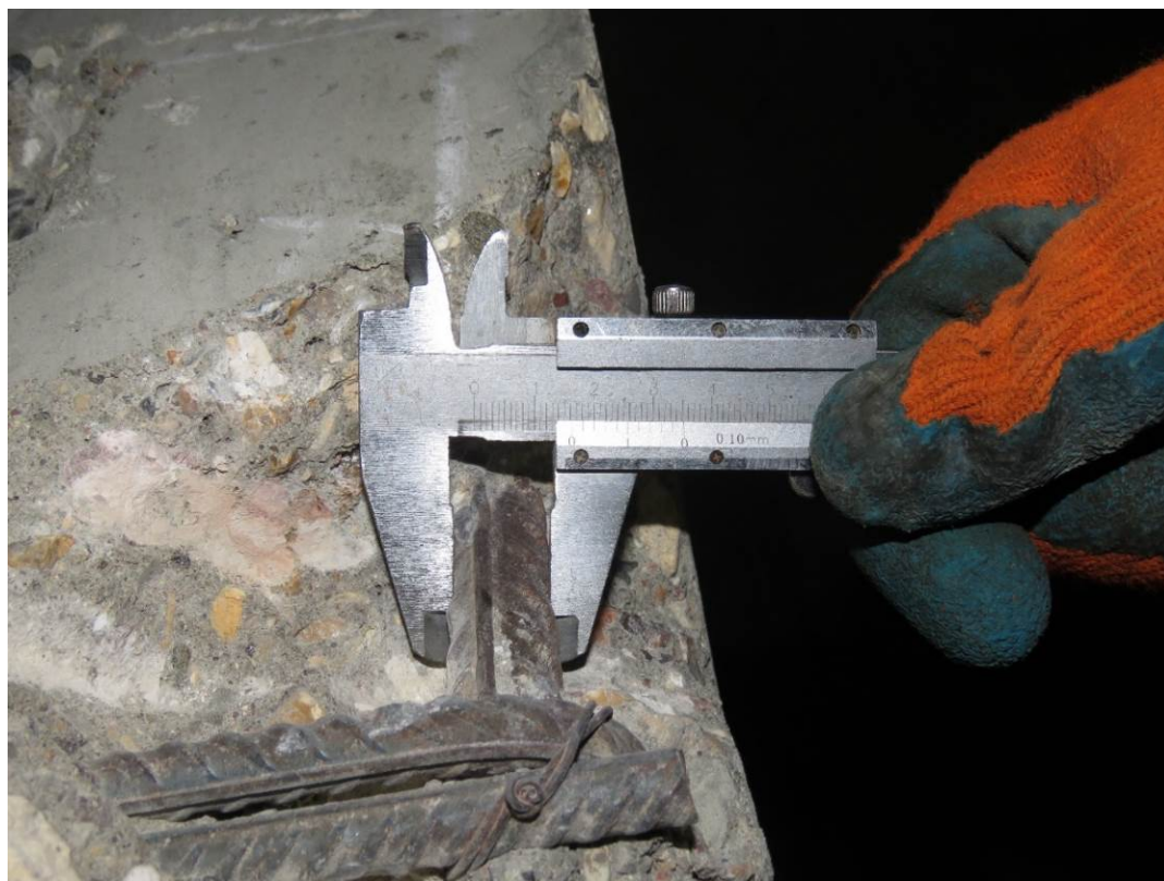
Рис. 3.2.3. Замер диаметра вертикального армирования стены на отм. -3,300 м между осями по оси В/4 между осями 3/4-4/4
