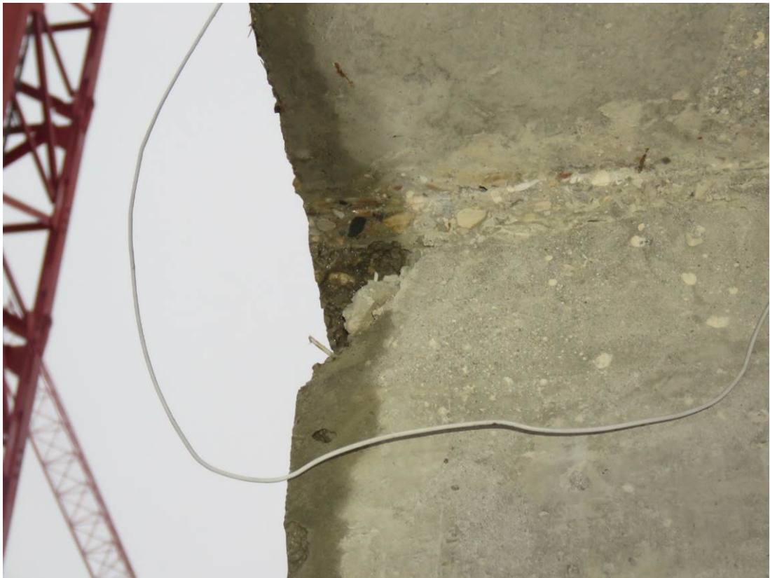
Рис. 3.2.5. Скол бетона монолитной ж.б. колонны на пересечении осей Д/6, 3 на отм. +3,000 м
