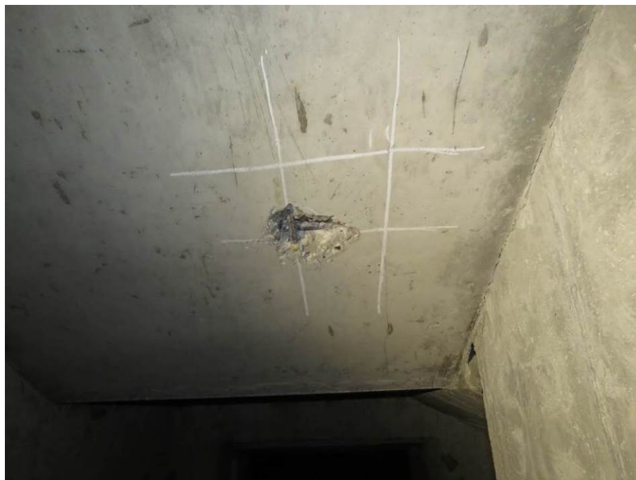
Рис. 3.5.9. Общий вскрытия марша на лестнице расположенной в зоне лифтовой шахты в зоне третьего этажа в осях 4/5-5/5 и Е/5-Д/5
