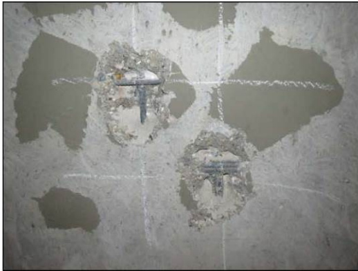
ФОТО 29. Общий вид вскрытия монолитного ж/б пилона 3-го этажа расположенного по оси «6/4» между осями «Б/4»-«В/4».
