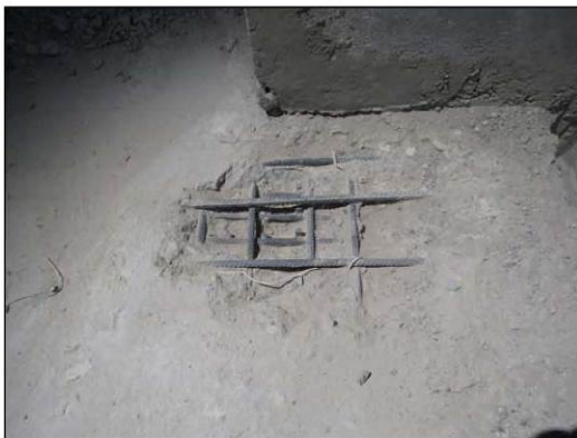
ФОТО 27. Общий вид вскрытия напольной поверхности монолитной железобетонной плиты перекрытия 2-го этажа расположенной по оси «А/4» между осями «3/4» и «4/4».
