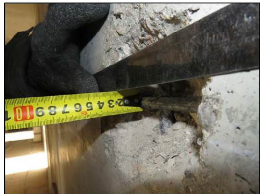
ФОТО 12. Уточнение защитного слоя бетона монолитной ж/б стены 1-го этажа расположенной по оси «Г/3» между осями «4/3»-«5/3».
