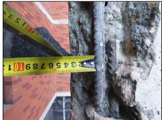
ФОТО 20. Уточнение защитного слоя бетона монолитной железобетонной колонны расположенной по оси «5/3» между осями «И/3» и «Ж/3».
