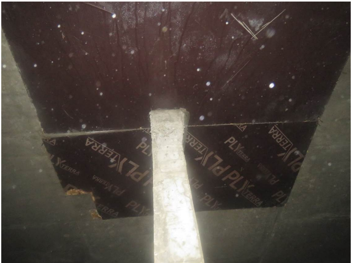
Рис. 3.2.6. Непроектное сечение оголовка колонны секции 4 между осями А/4-Г/4, 1/4-4/4 на отм. +15,000 м
