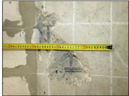
ФОТО 10. Уточнение шага рабочей арматуры монолитного ж/б пилона 1-го этажа по оси «В/4» между осями «3/4» и «4/4».
