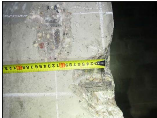
ФОТО 6. Уточнение шага рабочей арматуры монолитного ж/б пилона подвала по оси «В/4» между осями «3/4» и «4/4».
