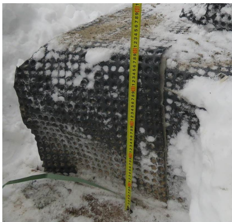
Рис. 3.1.2. Замер толщины фундаментной плиты в отрытом шурфе №1 секции 1 на пересечении осей 6/2 и Л/1
