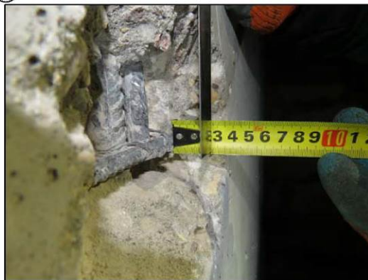
ФОТО 4. Уточнение защитного слоя бетона железобетонной стены расположенной на пересечении осей «1/4» и «Г/4».
