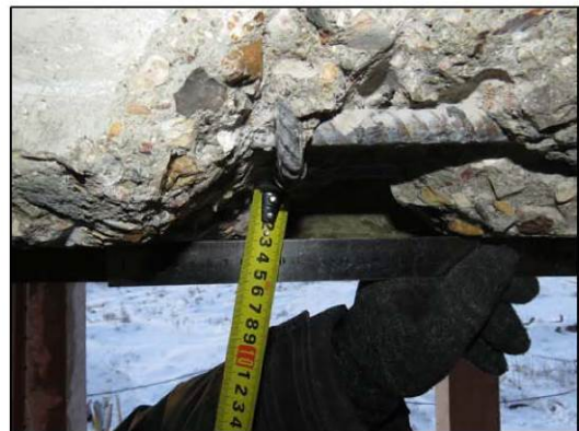
ФОТО 24. Уточнение защитного слоя бетона монолитной железобетонной балки расположенной по оси «2/4» между осями «Б/4» и «В/4».
