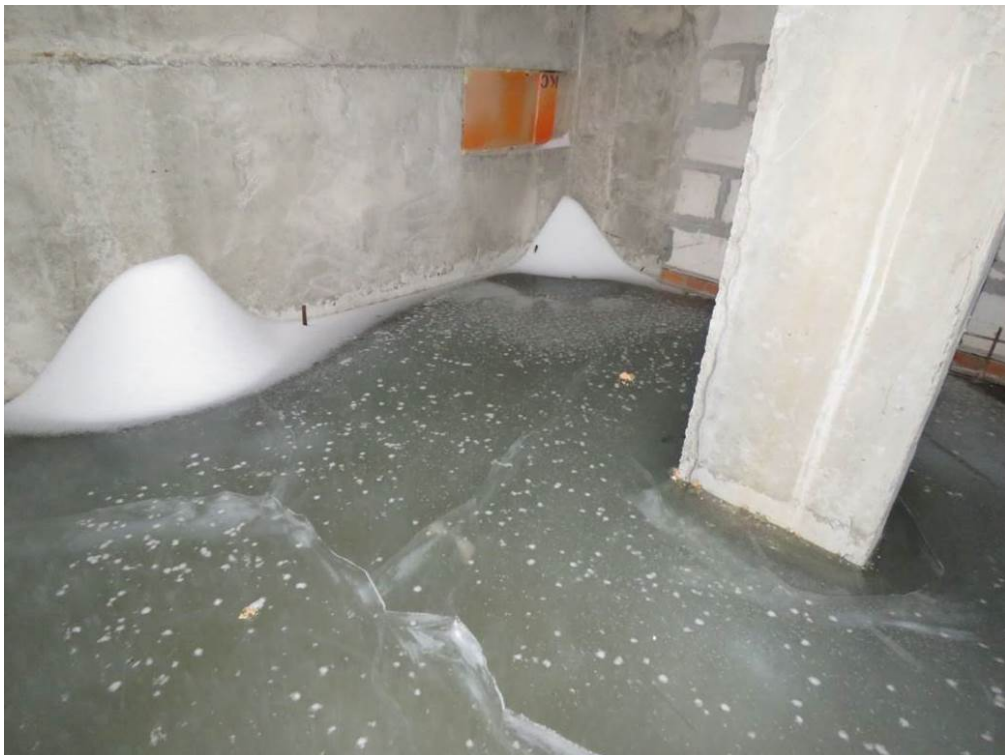
Рис. 3.1.12. Замачивание верхней поверхности фундаментной плиты с последующим замерзанием и фазового перехода воды в лед на высоту до 100 мм
